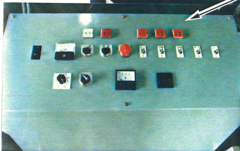
PHOTO 1 別置き操作盤
